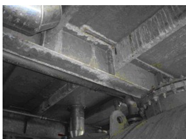
Foto 41. Vista de patologias de oxidação branca e vermelha por derrame de produtos.
