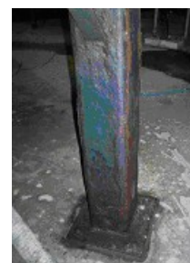
Foto 27. Vista de danos da oxidação nas colunas de sust. do transportadores
