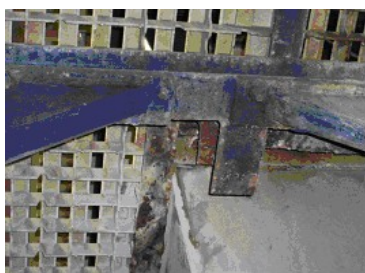
Foto 14. Vista de patologias na estrutura sustentação do piso superior na ETE.
