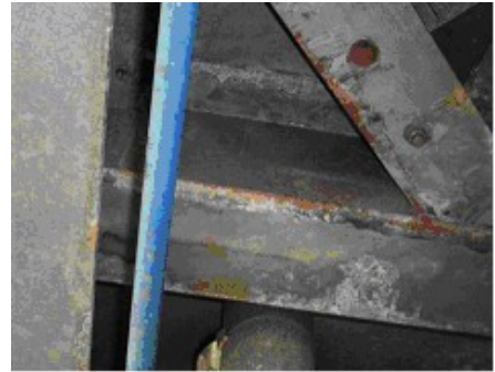
Foto 33. Vista de danos causados por derrames de produtos.
