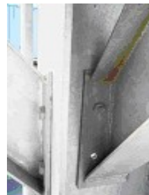
Foto 43 – Parafusos faltantes na estrutura.
