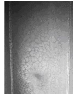
Foto 31. Vista de danos falhas de galvanização.
