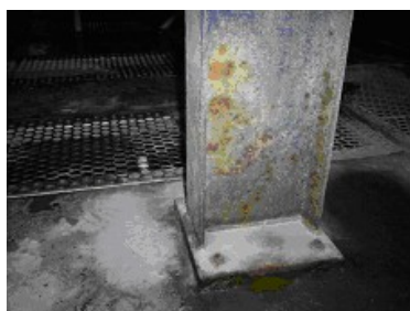
Foto 26. Anomalias na coluna, oxidação por pites.
