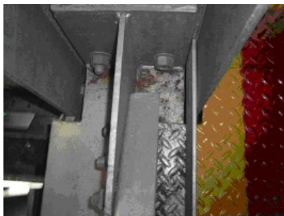
Foto 30. Vista de patologias em área sujeita a acúmulo de umidade.
