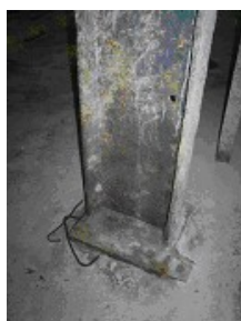
Foto 25. Detalhe de oxidação das colunas.
