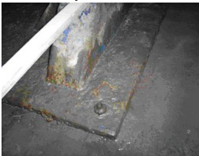
Foto 21. Vista de patologias nas bases das colunas de sustentação. Área da esmaltação.
