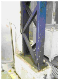
Foto 18. Patologias na coluna de sustentação da cobertura.
