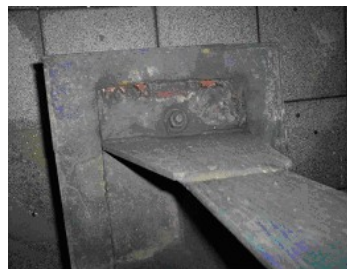
Foto 13. Patologias em áreas de solda na base de coluna.
