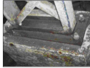
Foto 17. Patologias na base da estrutura da cobertura do Moinho.
